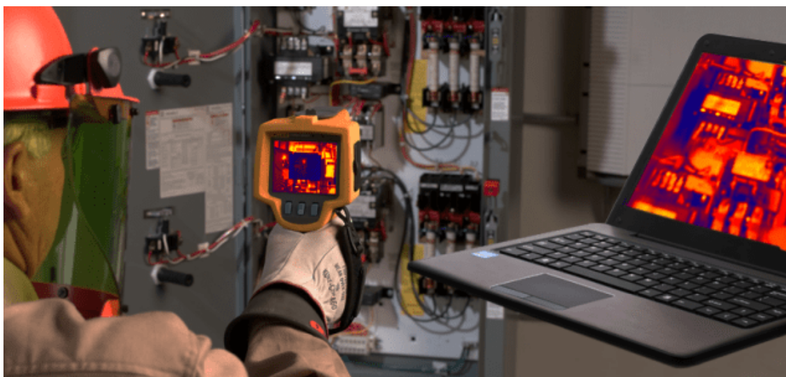
Рисунок 20. Пример проведения тепловизионного контроля электрошкафа
